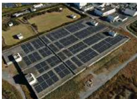
運営権者が設置した太陽光発電設備 浜松ウォーターシンフォニー㈱提供
