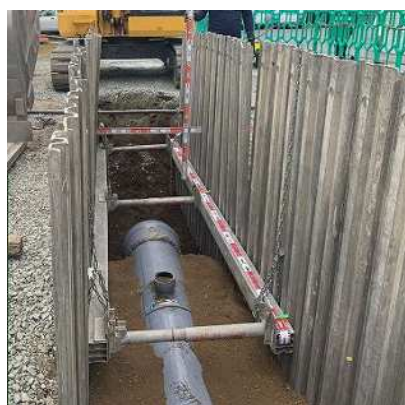
下水道の整備
