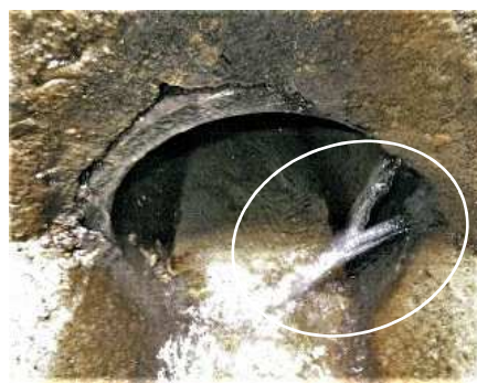
下水道管路の老朽化による浸入水
