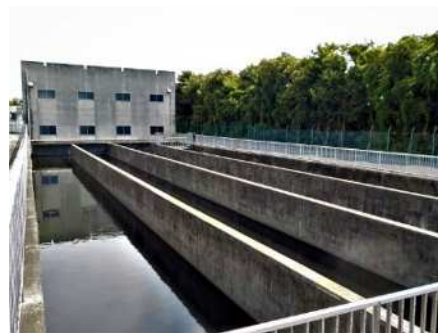
中部浄化センターの供用開始当時から稼働している塩素混和池
