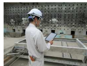
タブレットを用いた日常点検 [大原浄水場]
