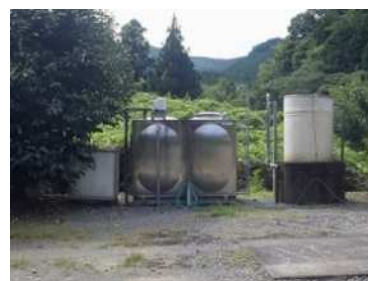
小規模水道施設 〔個人宅〕
