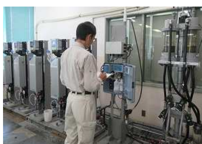
水処理工程における 水質監視用計器の維持管理（点検） 〔大原浄水場〕
