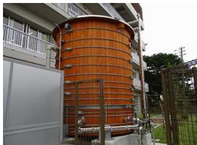
応急給水所として利用する受水槽 [船越小学校]
