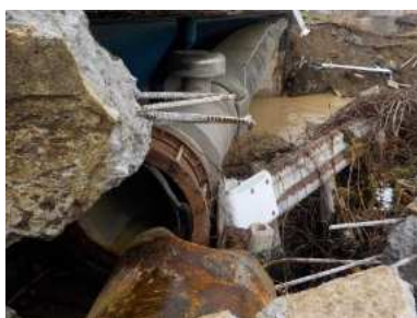
令和6年能登半島地震の影響で 破損した水道管路 [石川県珠洲市]
