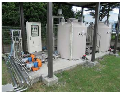
かび臭物質等を除去するための粉末活性炭注入設備 （2020年度導入）〔取水施設（三方原用水第6分水口）〕
