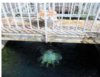
省エネルギー設備へ 更新予定の急速攪拌機 〔常光浄水場〕
