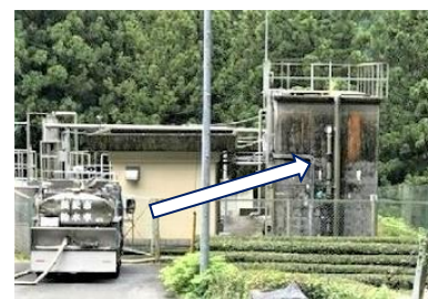
給水車から配水池への補水
