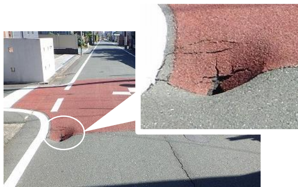
下水道管路の老朽化に起因する道路陥没 (2024 年度) [中央区高林三丁目]
