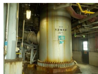
汚泥焼却炉 [中部浄化センター]
