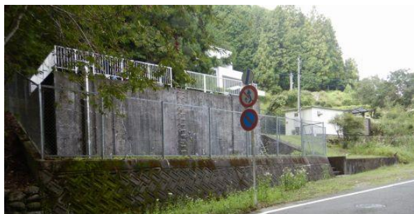
濁水対策のため、急速ろ過機の導入による浄水施設の機能強化を検討している中山間地域の配水池
