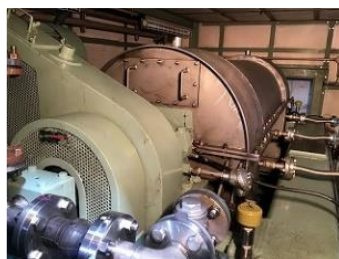
省エネルギー設備へ 更新予定の遠心濃縮機 〔館山寺浄化センター〕
