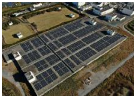
運営権者が設置した太陽光発電設備 浜松ウォーターシンフォニー㈱提供
