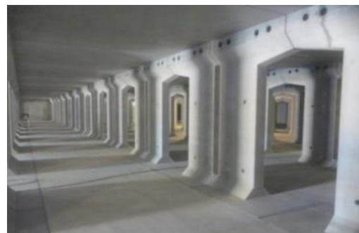
公園の地下に整備した雨水貯留施設 (2019 年度 供用開始) ※写真は建設当時 [可美地区（高塚川エリア）]
