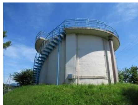
大原浄水場の供用開始当時から稼働している着水井
