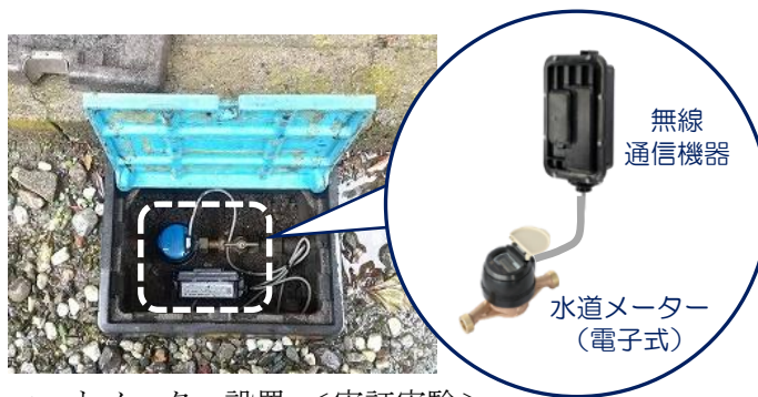
水道スマートメーター設置 <実証実験> (2023～2024 年度)
