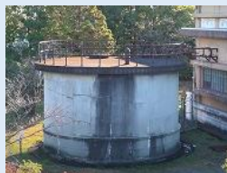
旧住吉浄水場 直送ポンプ井
