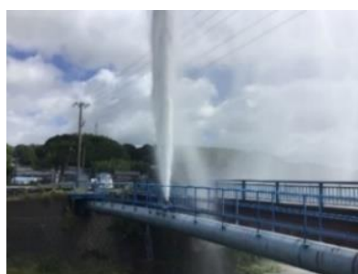
水管橋の空気弁の老朽化に起因する漏水 (2023年度) [中央区伊左地町]
