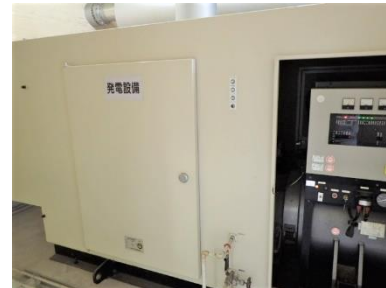
更新予定の非常用発電機 〔小林配水場〕
