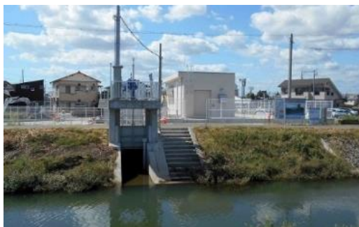
新たに整備した天王雨水ポンプ場 (2022 年度 供用開始) [中央区天王町（安間川中流エリア）] ※安間川中流エリアではこのほかに市野雨水ポンプ場あり
