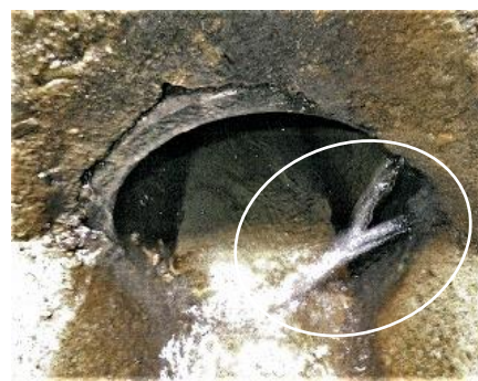
下水道管路の老朽化による浸入水
