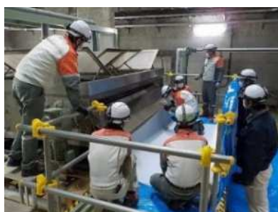
本市によるモニタリング (運営権者が行う点検作業の確認) [現地モニタリング]
