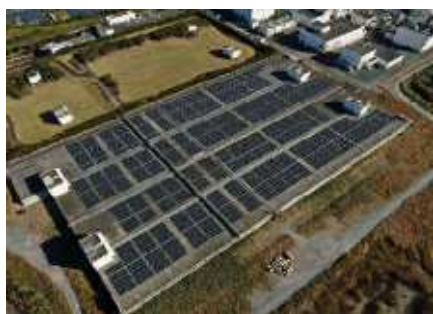
運営権者が設置した太陽光発電設備 浜松ウォーターシンフォニー(株)提供
