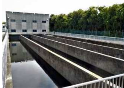
中部浄化センターの供用開始当時から稼働している塩素混和池
