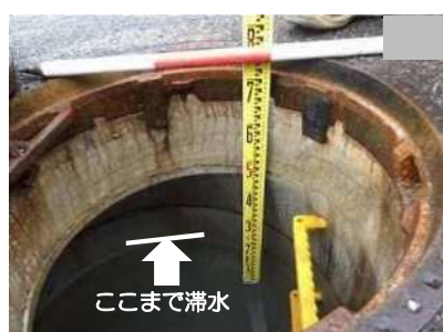
令和6年能登半島地震の影響で破損した 下水道管路に起因するマンホール内の滞水 〔石川県珠洲市〕
