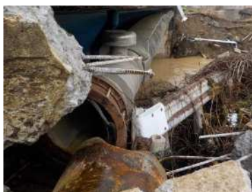
令和6年能登半島地震の影響で 破損した水道管路 〔石川県珠洲市〕
