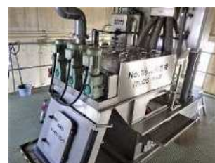
修繕予定の汚泥脱水設備 [三ヶ日浄化センター]
