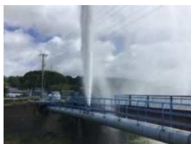
水管橋の空気弁の老朽化に起因する漏水 (2023年度) [中央区伊左地町]
