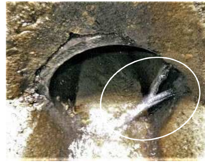
下水道管路の老朽化による浸入水
