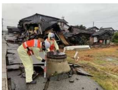
令和6年能登半島地震の影響で 浮上したマンホール 〔石川県珠洲市〕
