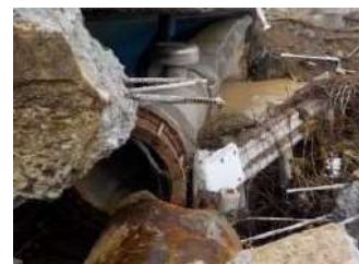
地震の影響で破損した水道管路 [石川県珠洲市]
