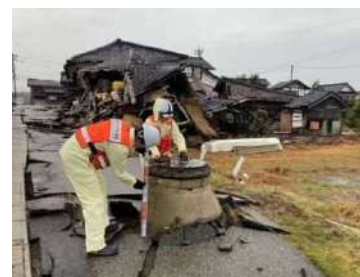
地震の影響で浮上したマンホール [石川県珠洲市]
