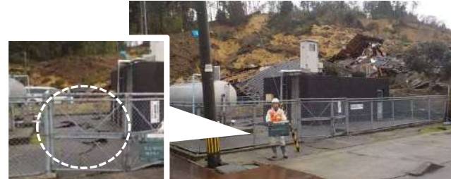
地震の影響で破損したポンプ場 〈水道施設〉[石川県珠洲市]
