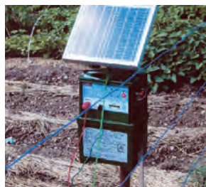
侵入防止対策として設置した電気柵と電源機器（天竜区山東）
