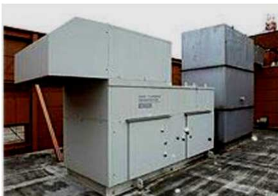
非常用自家発電設備
