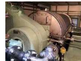
省エネルギー設備へ更新予定の遠心濃縮機 [館山寺浄化センター]
