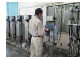
水処理工程における水質監視用計器の点検 [大原浄水場]
