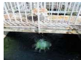
省エネルギー設備へ更新予定の急速攪拌機 [常光浄水場]
