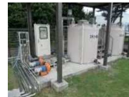
かび臭物質等を除去するために導入した 粉末活性炭注入設備 (令和2年度)〈浄水機能の強化〉 [取水施設（三方原水第6分水口）]
