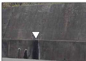
地下水の流出
