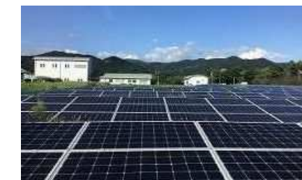
既存の太陽光発電設備 [三ヶ日浄化センター] （今後、他の上下水道施設への導入を検討予定）
