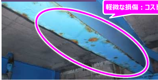
健全性Ⅱの事例（橋梁）
