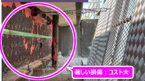
健全性Ⅲの事例（橋梁）
