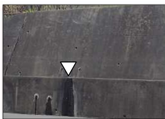
地下水の流出
