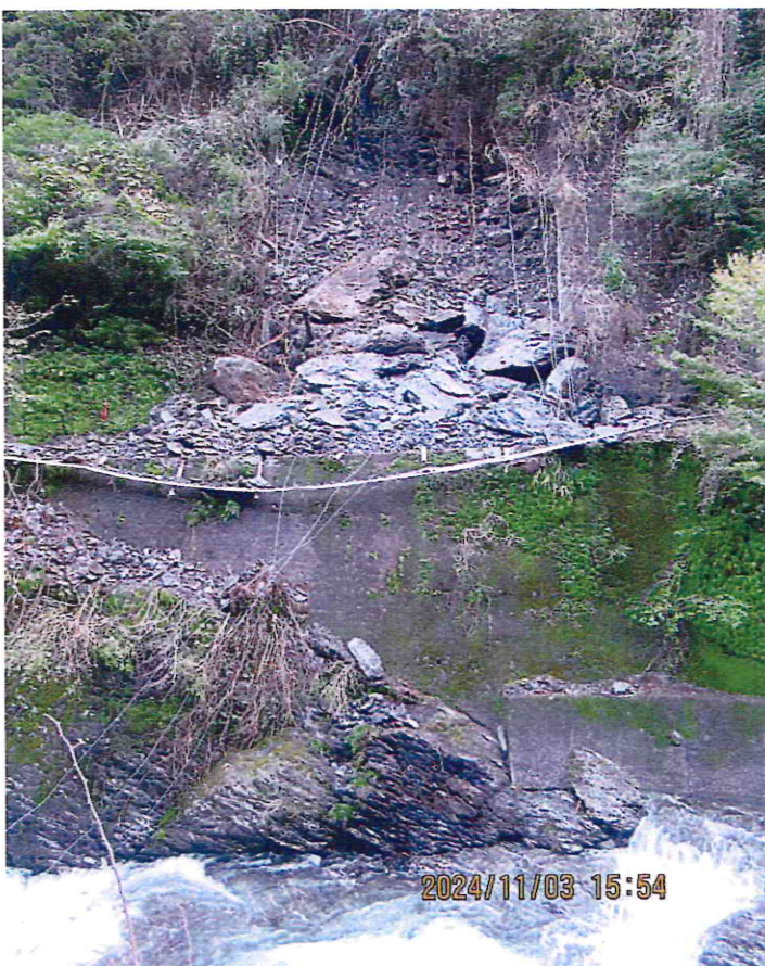
↑ 県道白倉西川線の岩盤崩壊 10月24日発生 高さ15m 幅20m 龍山町西川地内 (撮影 11月3日 酒井 )
