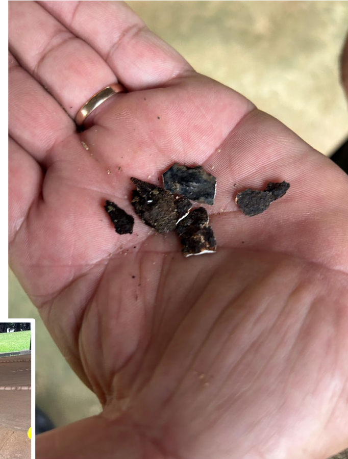
【風車公園 相撲場】 写真：屋根からの落下物
