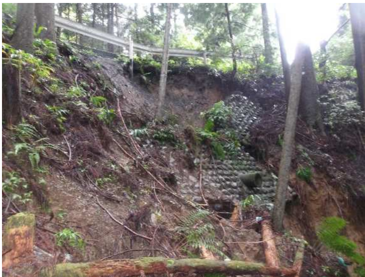
市道春野サルゴダ大時線(法面崩壊)
