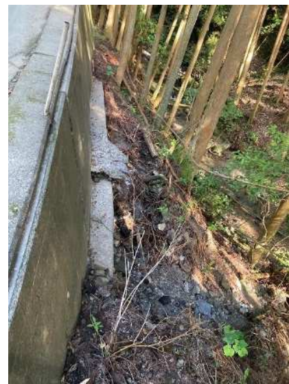
林道天竜線（路肩崩壊）
