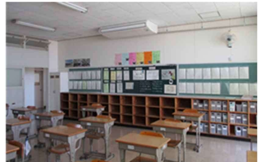
市立小中学校空調設備
