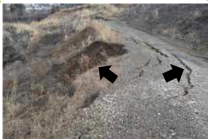
＜盛土の浸食・亀裂＞
