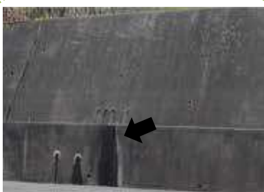
＜地下水の恒常的なしみ出し＞
