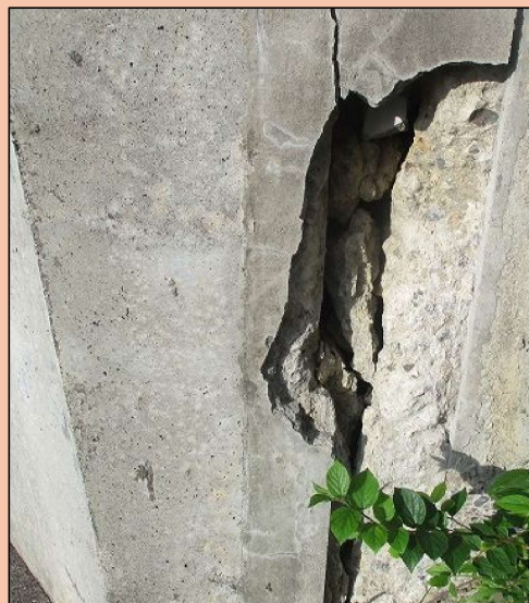
擁壁のひびれ割
