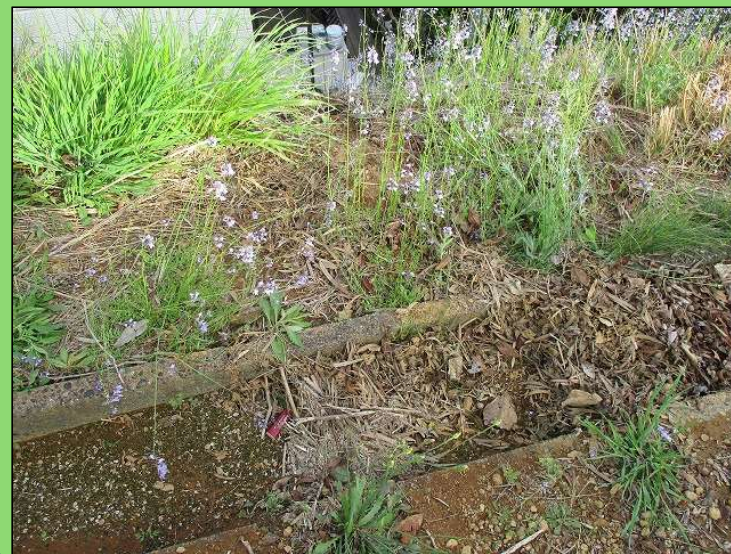
排水路の閉塞
