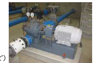
【参考】ポンプ設備
