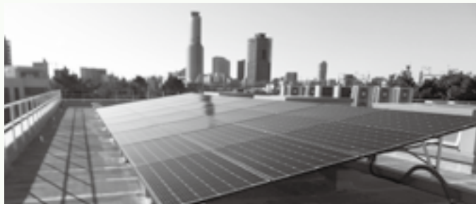
▲東部協働センターの屋上に設置されている太陽光パネル
