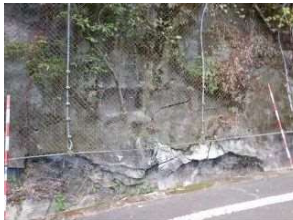
既設モルタル吹付の剥離(国道473号)
