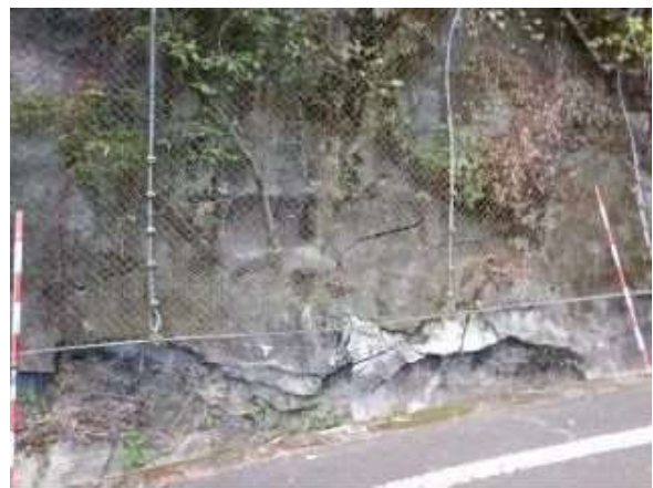
既設モルタル吹付の剥離(国道473号)
