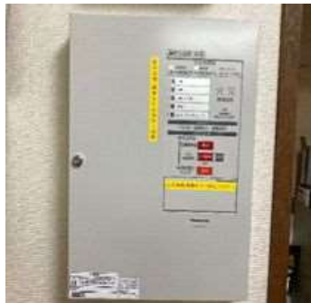
大規模修繕等(火災通報装置)
