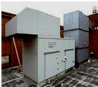
非常用自家発電設備
