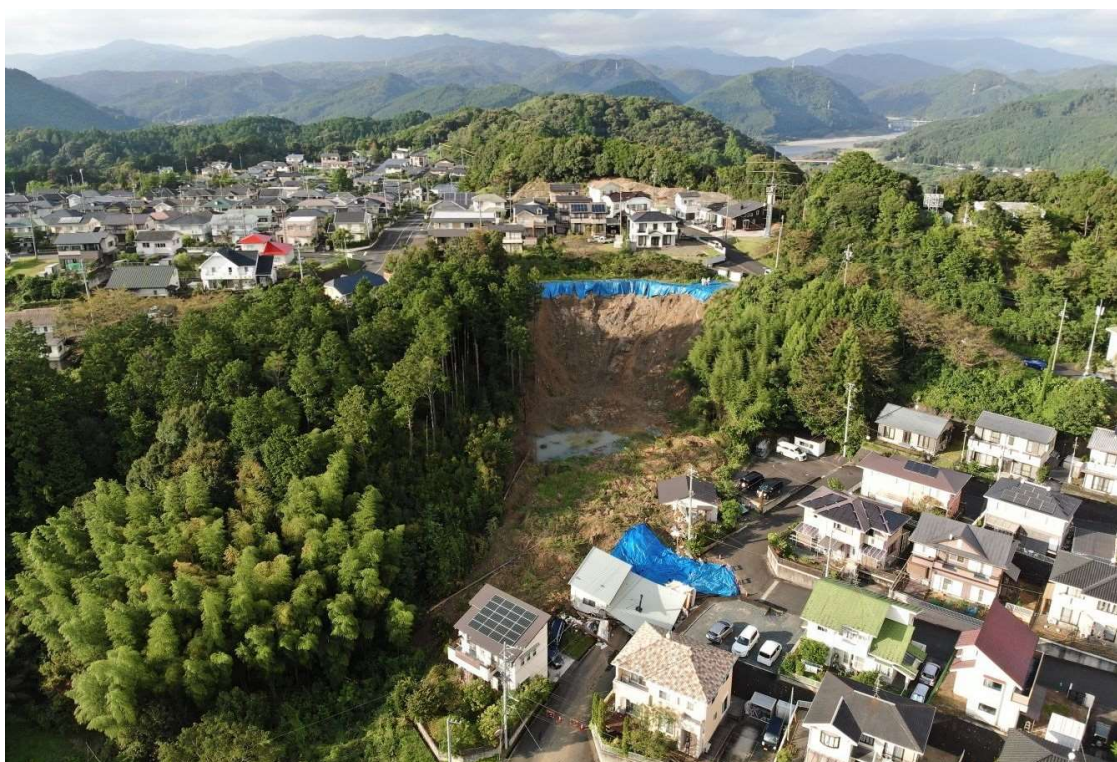
写真 1.1 被災状況（令和 4 年 9 月 25 日撮影）
