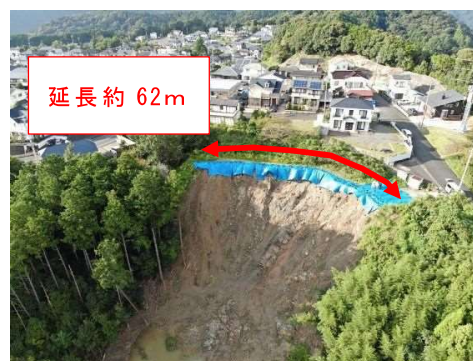
写真-2.2.1 崩落後地形 (2022年9月25日撮影)
