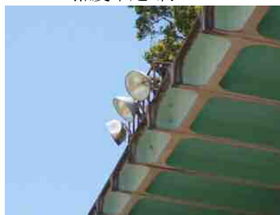
【夜間照明】 照度不足 約90Lx
