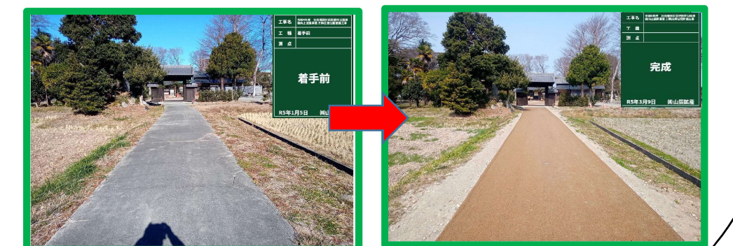
⑥南から北を望む クラックが目立つコンクリート土間→透水性舗装
