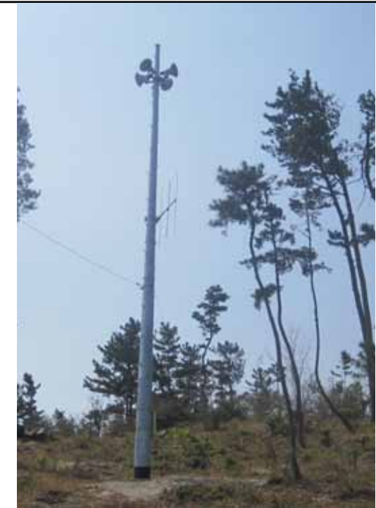
写真 同報無線の屋外スピーカー
