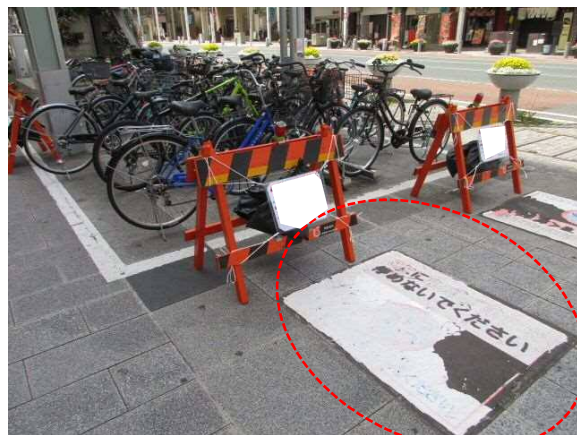
図 43- 駐車場の注意喚起標識の劣化状況
