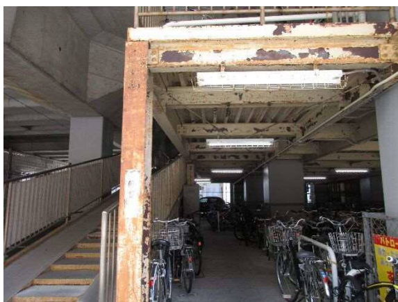
図 42- 駐車場施設の塗装の劣化状況
