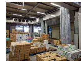
定温化された仲卸売場
