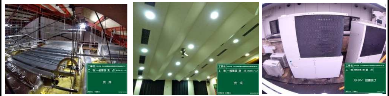
室内機 (多目的ルーム天井内)
