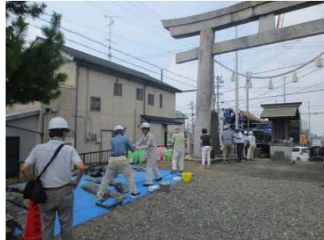
令和7年8月4日 小松秋葉常夜燈龍燈（覆屋）修理 瓦解体・へら書き確認サポート作業
