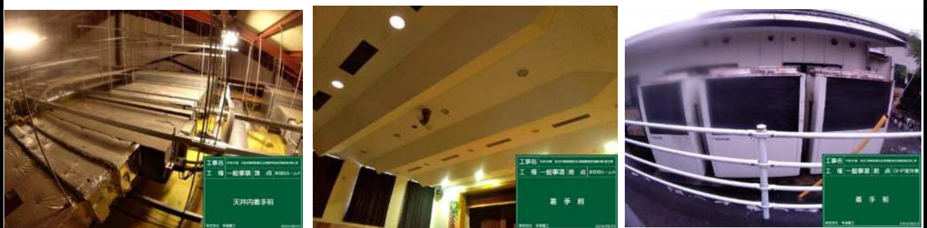
室内機 (多目的ルーム天井内)
