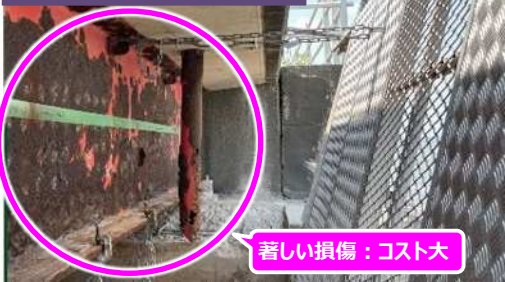
健全性Ⅲの事例（橋梁）
