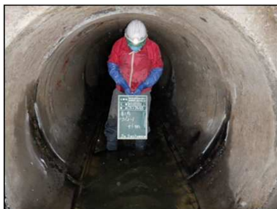
<改築前> 老朽化した管路
