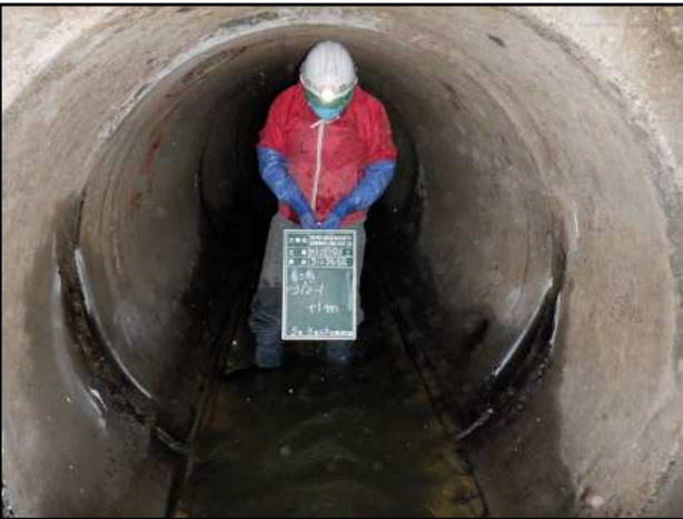
＜改築前＞老朽化した管路
