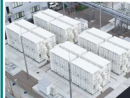
系統用蓄電池 ※民間 (2025年運転開始予定)
