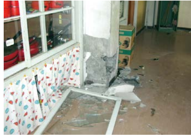
事例① ガラスの破損
