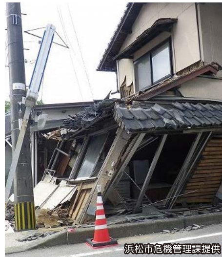
事例③ 建物の倒壊
