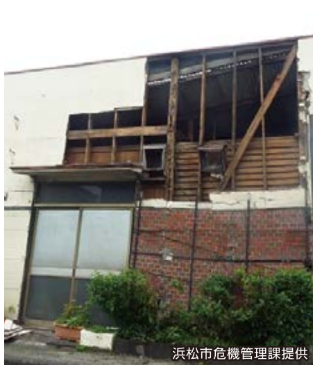
事例② 壁の落下
