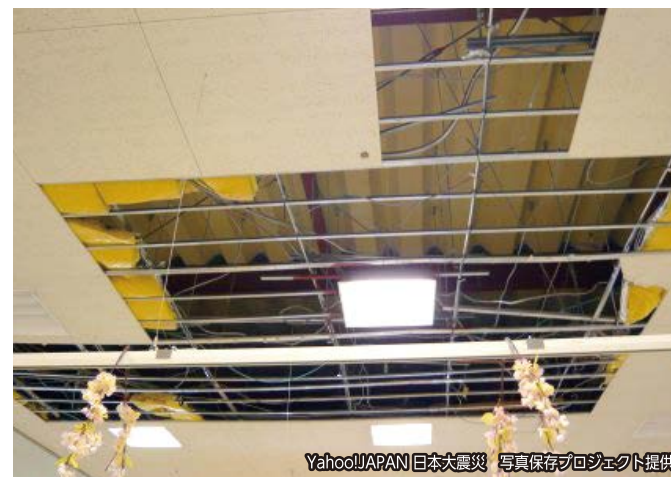
事例③ 天井材の落下
