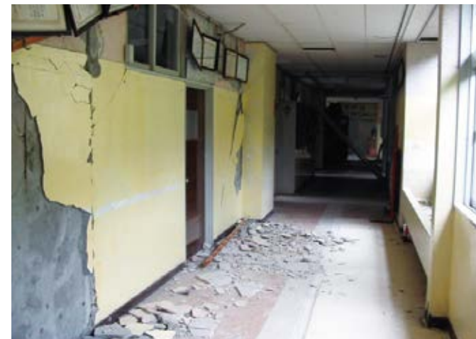
事例② 壁のはくり
