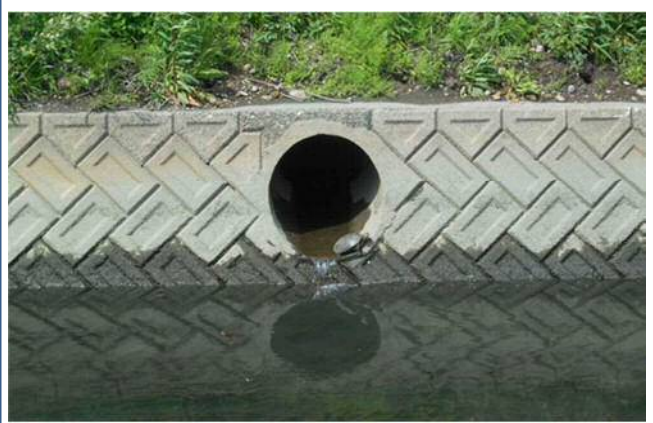
令和2年度現在状況(逆流防止施設)
