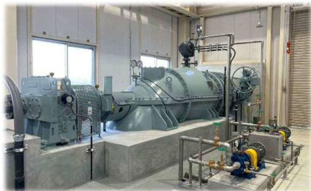
第2排水機場 ポンプ設備
