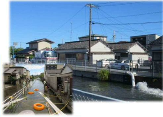
H27年9月の排水ポンプ車設置状況
