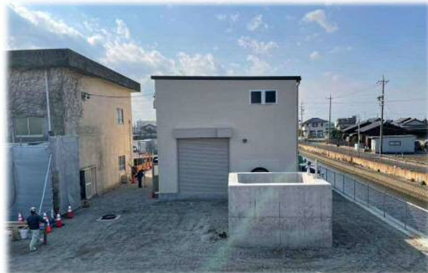
第2排水機場 上屋工及び吐水槽
