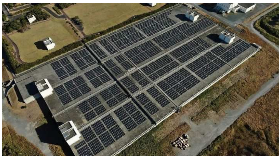
西遠浄化センターにおける太陽光発電設備
