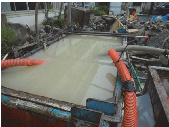
図2 石綿含有汚染水(原水)
