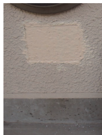
採取痕の簡易塗装補修例
