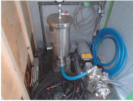
写真7 膜ろ過装置の外観
