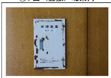
⑯排煙窓オペレーター
