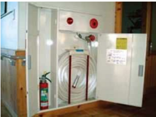
消火器、屋内消火栓
