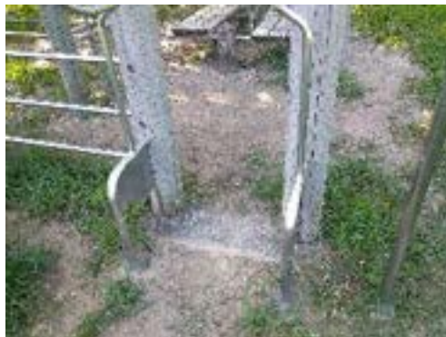
(落下時基礎露出)
