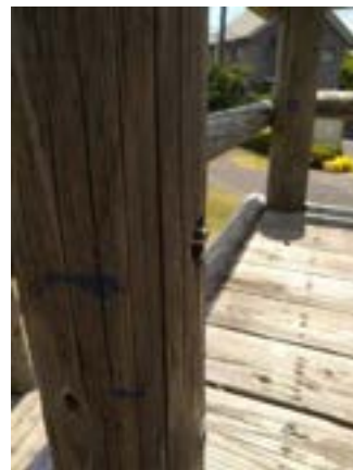
(ボルトの飛び出し)
