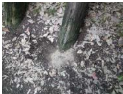
(落下時基礎露出)
