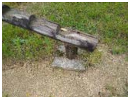
(落下時基礎露出)
