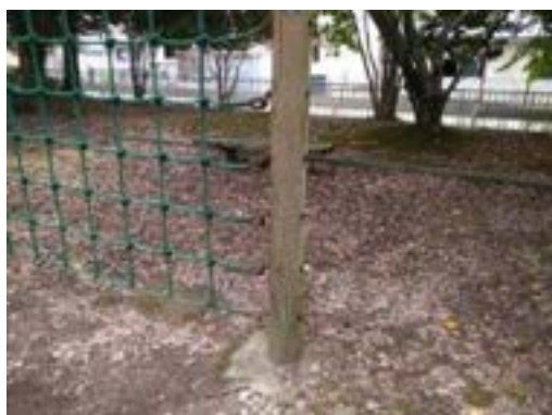
(落下時基礎露出)
