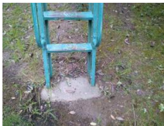
(落下時基礎露出)
