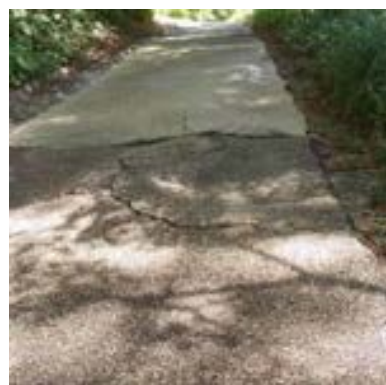
劣化した園路（舘山寺総合公園）
