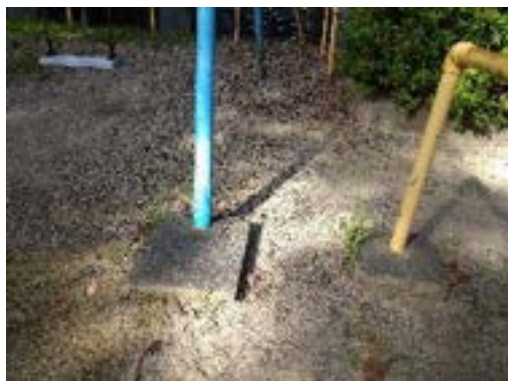
（落下時基礎露出）
