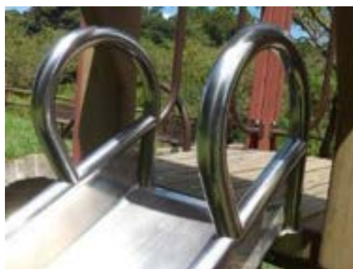
（出発部有害な隙間）
