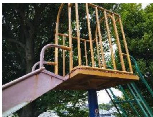
(出発部有害な隙間 出発部腐食)
