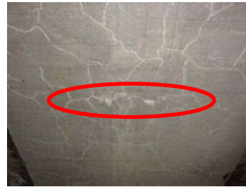
貫通ひびわれあり
