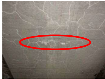
貫通ひびわれあり
