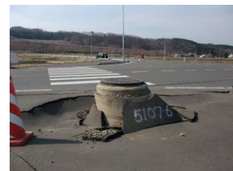
液状化の被害例
