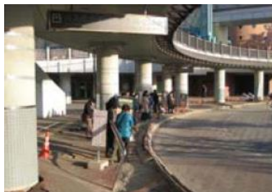
浦安市における地盤沈下の被害例
