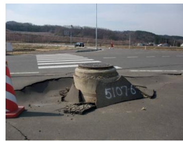
東日本大震災による液状化の被害例 （千葉県浦安市）
