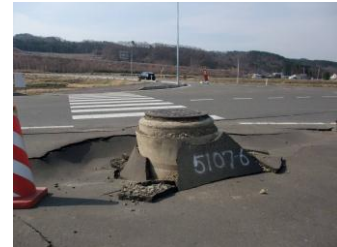
液状化の被害例
