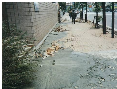
液状化による被害例
