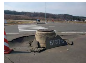
液状化の被害例
