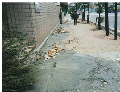
液状化による被害例
