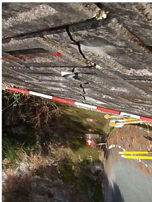
ブロック積擁壁面にみられる水平クラック
