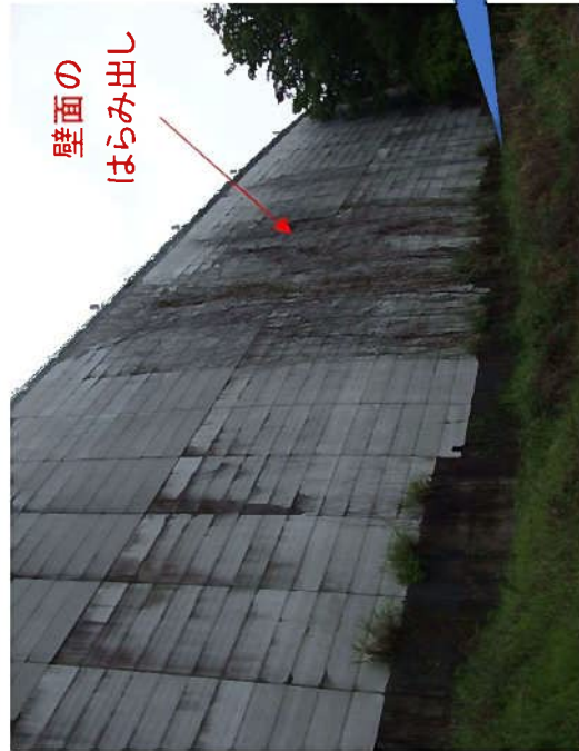
軽量盛土の壁面にはらみ出し
