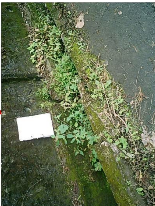
擁壁・水路のずれ
