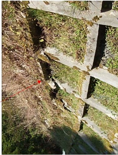
法枠のずれ亀裂
