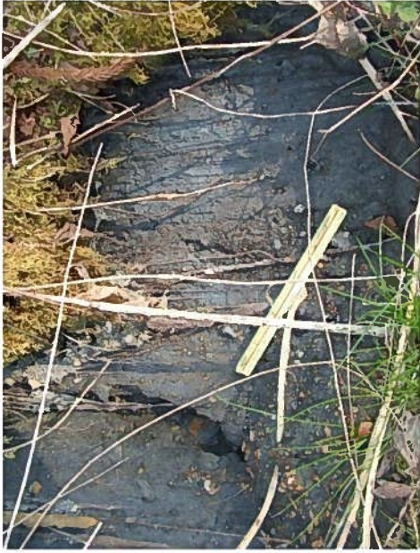
枠内にみられる地山亀裂
