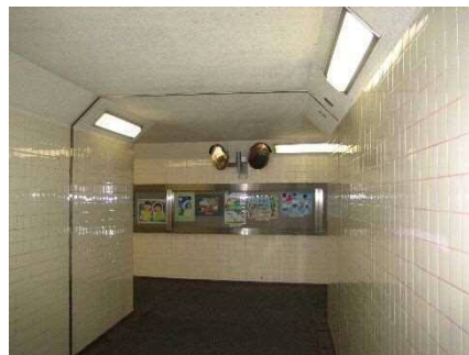
[地下道の照明灯の例]
