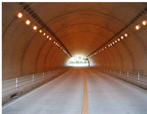
[トンネル照明の例]
