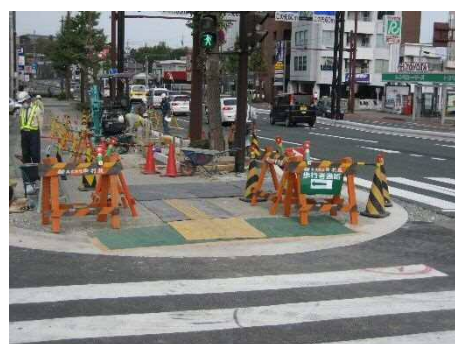
[視覚障害者用誘導マットを設置した例]
