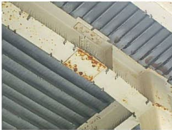
鉄骨表し部 搬入路下部 錆が目立つ
